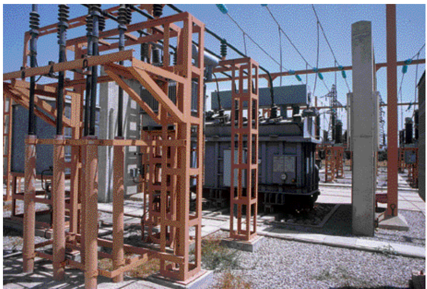
Poste de livraison électrique réalisé par la RADEEF financé en 1987
